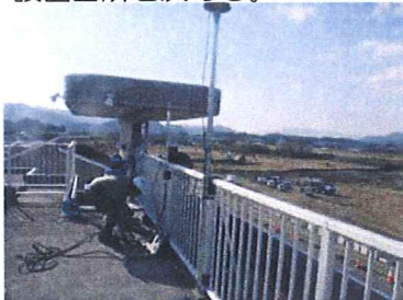
固定局設置状況
